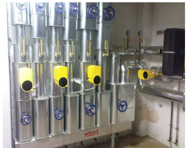
Technikzentrale - nach der Sanierung
