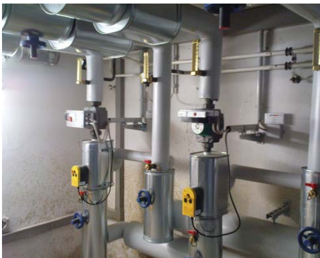
Technikzentrale nach der Sanierung
